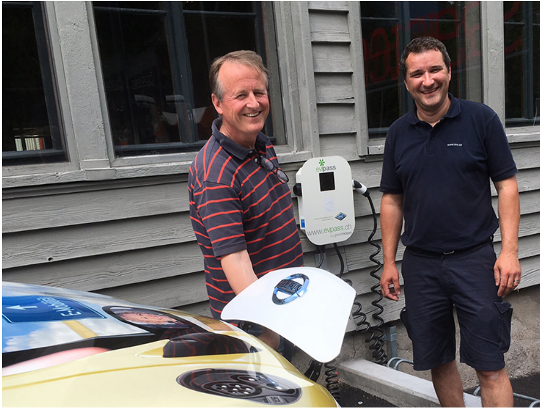
Freuen sich über die neu installierte Ladestation am Walensee: Dieter von Ziegler, Geschäftsleiter Restaurant Sagibeiz (links) und Andreas Aebli, Servicemonteur der SAK.
